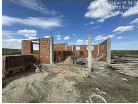
Türkmenli Mah. 251 Parsel Ruhsatsız Yapı
