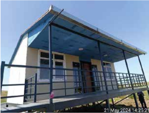
Yeniçiftlik Mah. 484 Parsel Ruhsatsız Yapı
